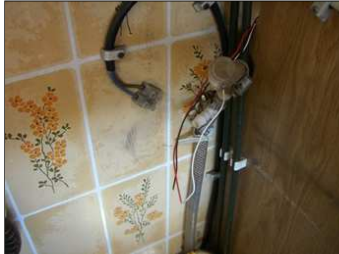
Links die Strombrücke der Lampe, rechts das rote, schwarze und weiße Kabel des Lüfters (weiß wird gleich gekappt)
