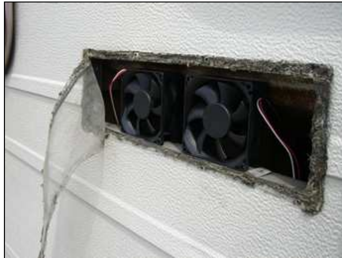
Ob ein oder zwei Lüfter hängt von der Stärke des Lüfters ab
