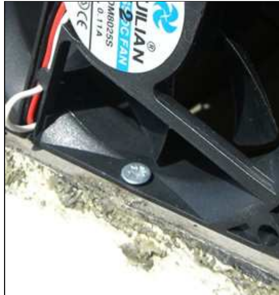
Lüfter verschraubt, Lüfterblätter sind freigängig
