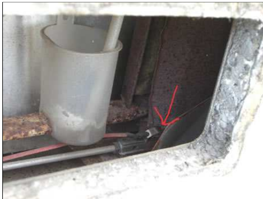
So sieht der Brennerkopf im eingebauten Zustand hinter dem unteren Lüftergitter aus
